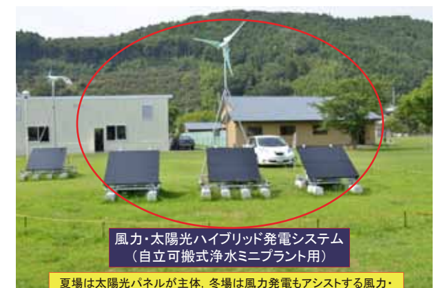
写真1 風力・太陽光ハイブリッド発電システムの全容
