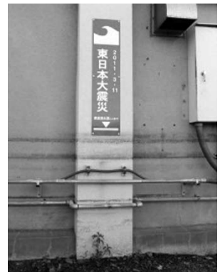
宮城県東部土木事務所(石巻市東中里)壁面にある津波浸水高を示す標識、その下の二本の線は津波浸水の跡と思われる
