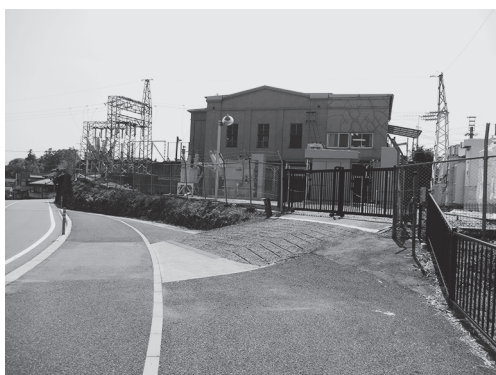
写真 9. 上毛電気鉄道の登録文化財の一つである大胡変電所（大胡駅前、2015.7.10）
