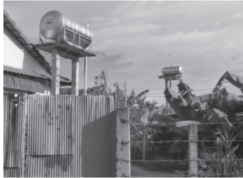
電動ポンプを使った水タンク
