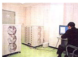
■写真3「SPACE」の外観。一つの箱の中にパソコン16台が入っており、合計32台をギガビットイーサネットに接続
