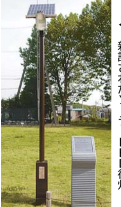
新設されたソーラーLED街灯
